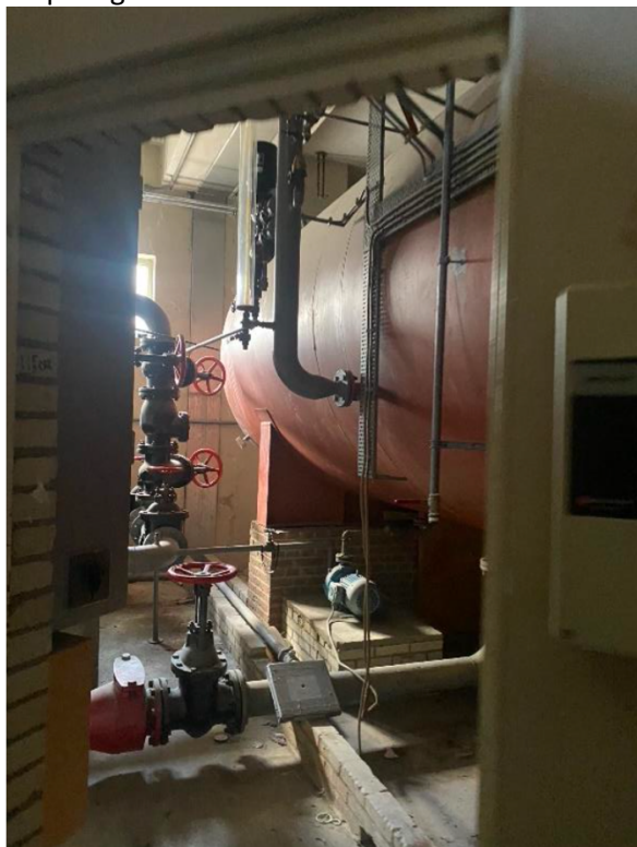
Sprinklertank, buiten gebruik
